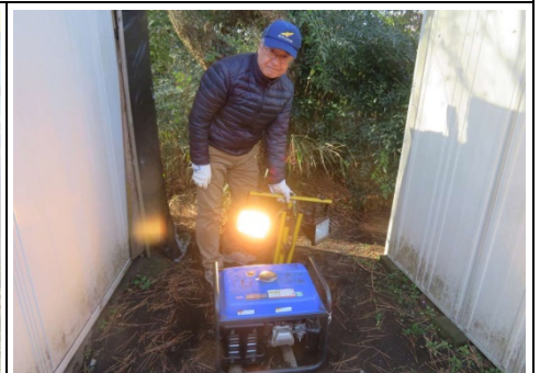
発電機と投光器点検の様子
