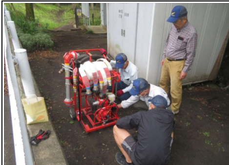
小型消防ポンプ点検の様子
