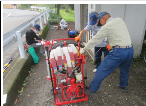
小型消防ポンプ点検の様子
