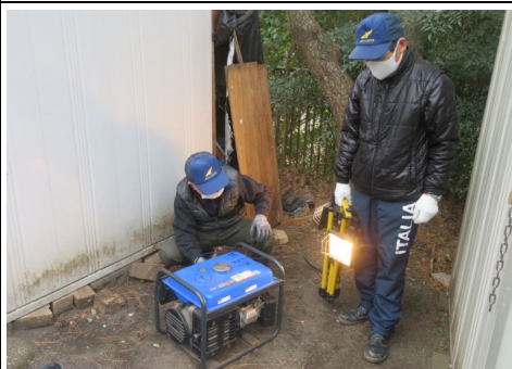
発電機と投光器点検の様子
