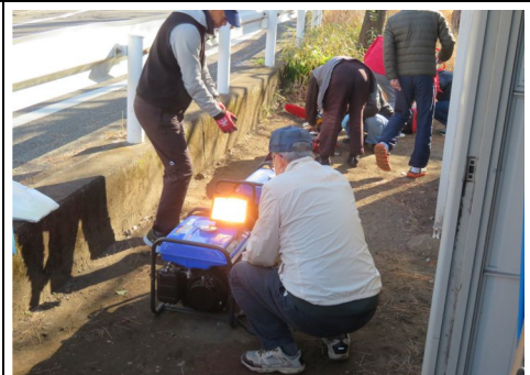
発電機と投光器点検の様子
