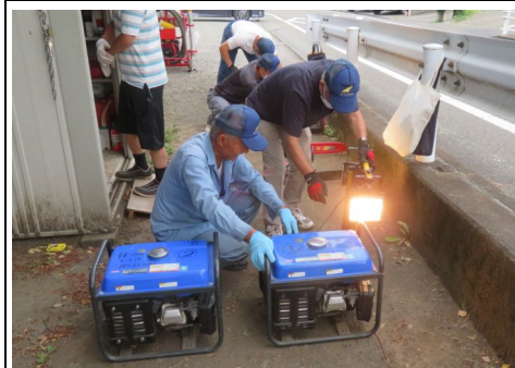
発電機と投光器点検の様子
