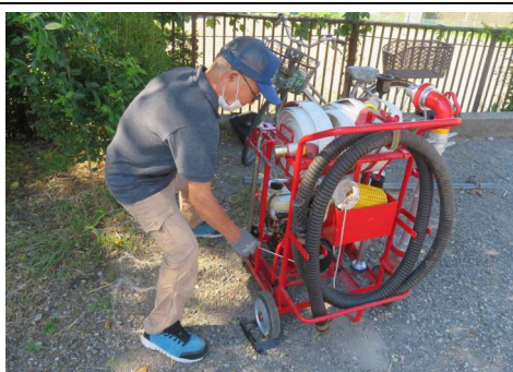
小型消防ポンプ点検の様子
