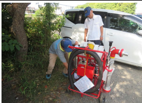
D級ポンプ点検の様子
