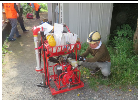
D級消火ポンプ点検の様子
