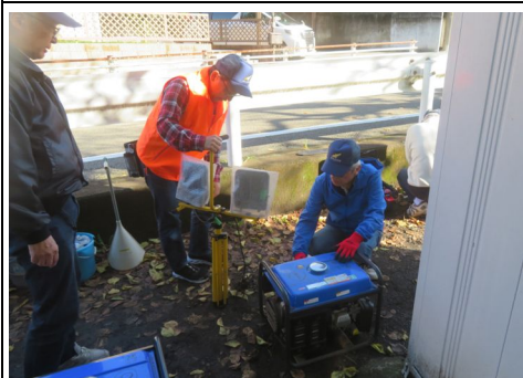
発電機と投光器点検の様子
