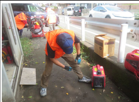
発電機点検の様子
