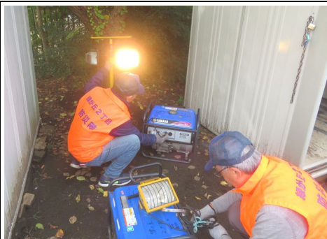
発電機と投光器点検の様子
