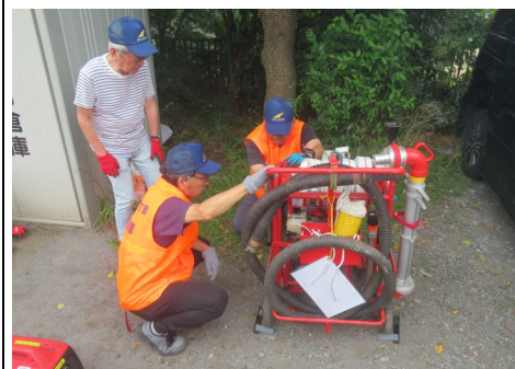
D級消火ポンプ点検の様子
