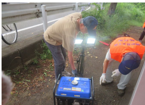
発電機と投光器点検の様子
