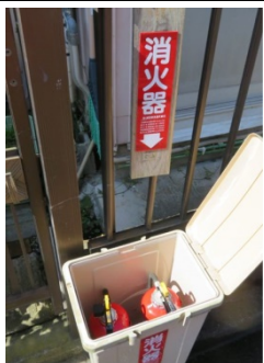
増設された消火器
